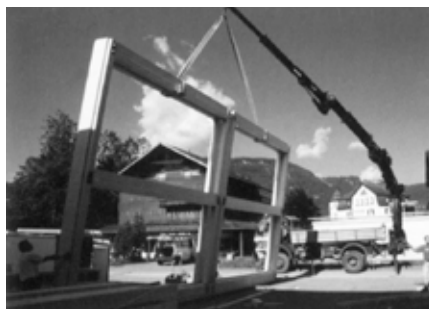
Mise en place du cadre principal (Prefabricated systems, Birkhauser Verlag AG, 2013, 133p).
