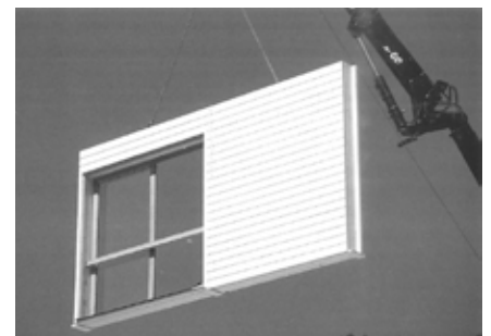
Mise en place d'un panneau de façade (Prefabricated systems, Birkhauser Verlag AG, 2013, 133p).
