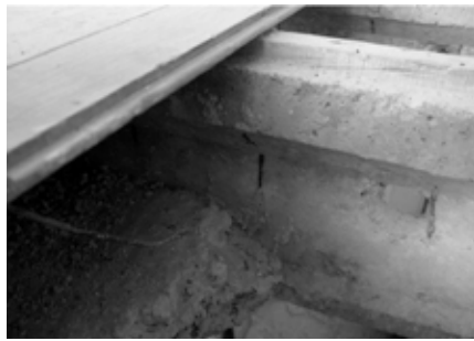
Poutre en béton du plancher (photographie, habitants de la Cité Frugès, http://fruges.lecorbusier.free.fr/.html ).
