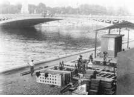
Les éléments préfabriqués sont livrés (Marrey, Bernard, L'abbé Pierre et Jean Prouvé, Édition du linteau, Paris, 2010, 80p).
