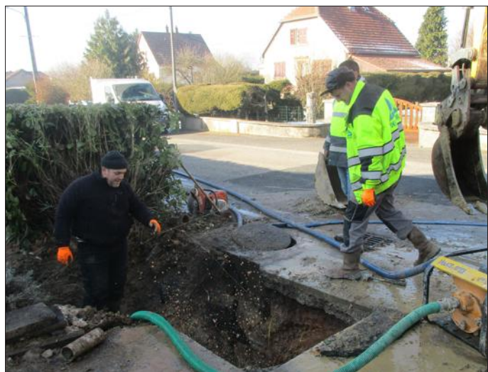
Le week-end des habitants du quartier a été perturbé par cette fuite importante. Photo RL
