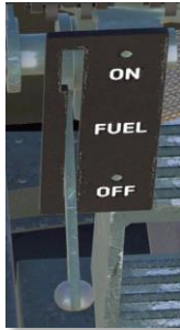
Vanne principale de carburant
