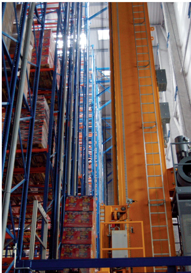
On aurait tort de sous-estimer le caractère crucial du WCS dans un entrepôt automatisé.
