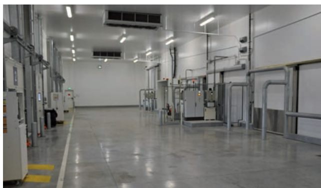
La zone de réception/expédition de 500 m 2 permet de traiter les arrivées et départs de marchandises via 6 quais.
