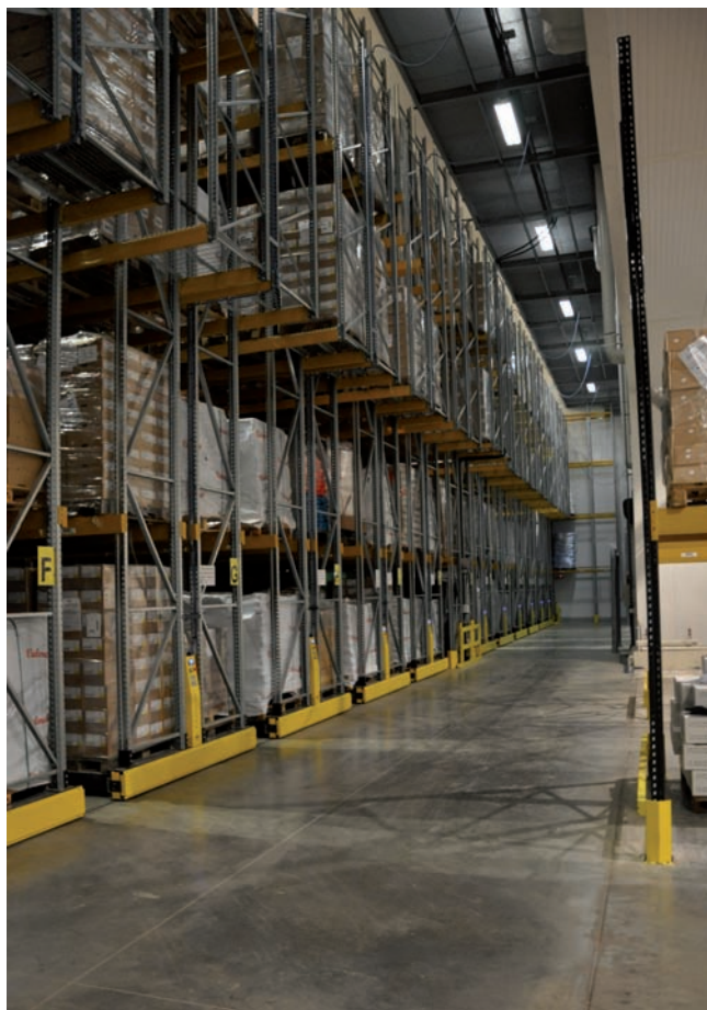
Le volume de stockage dans la chambre froide a été optimisé, et un espacement a été maintenu entre les rangées pour faciliter la circulation du froid.
