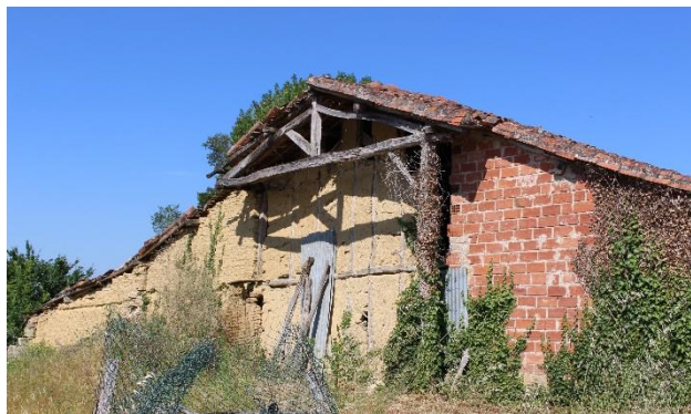
Ferme du XIXe siècle à Poujoles-haut en pan-de-bois et brique de terre crue, agrandie en brique creuse et aujourd'hui en mauvais état.
