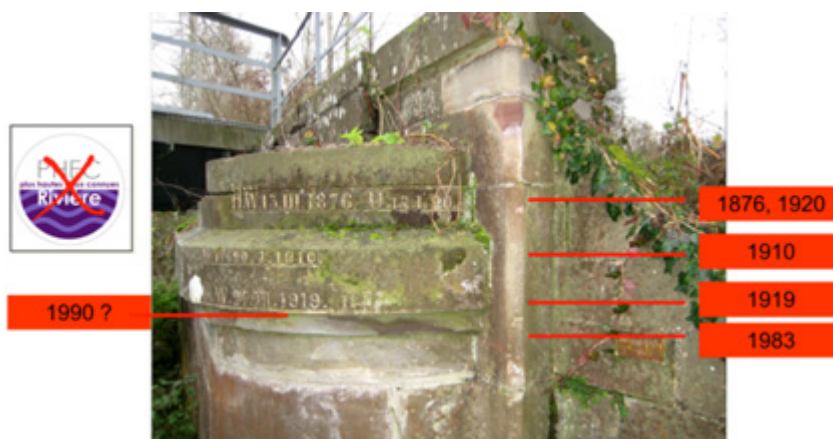
Fig. 1 : un des rares repères de crue du Haut-Rhin (pont SNCF, forêt du Neuland, sud de Colmar) conservant des informations sur les hauteurs d'eau atteintes par les événements s'étant succédés depuis 1876. Aucune plaque informative de type PHEC (plus hautes eaux connues) n'a encore été posée en Alsace, malgré l'obligation légale pour toutes les communes dotées d'un PPRI (+ de 300 !). Notez les relatives faiblesses des crues de 1990 et 1983, par rapport à leurs devancières, sachant qu'il manque malheureusement les données sur 1947 et 1955.
