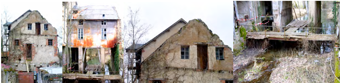
Maisons dégradées à Chavroches, Jaligny-sur-Besbre © Etienne Fradin
