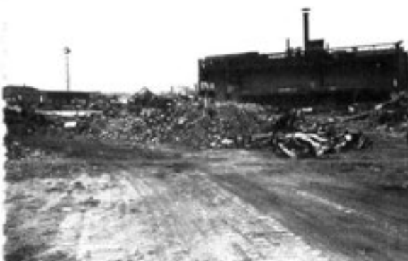
Le dégagement des terrains devant permettre le lancement de la première phase de l'opération d'aménagement est aujourd'hui achevé.
