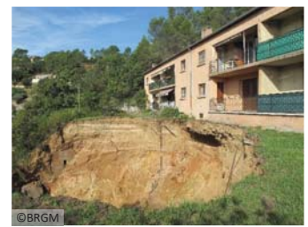
Effondrement du 8 octobre 2014 au Luc-en-Provence (Var - 83)
