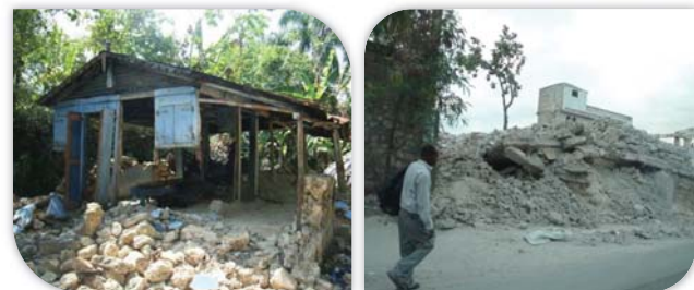
Habitat rural endommagé par le séisme – A. Douline / Ruines dans Port-au-Prince détruit – P. Garnier
