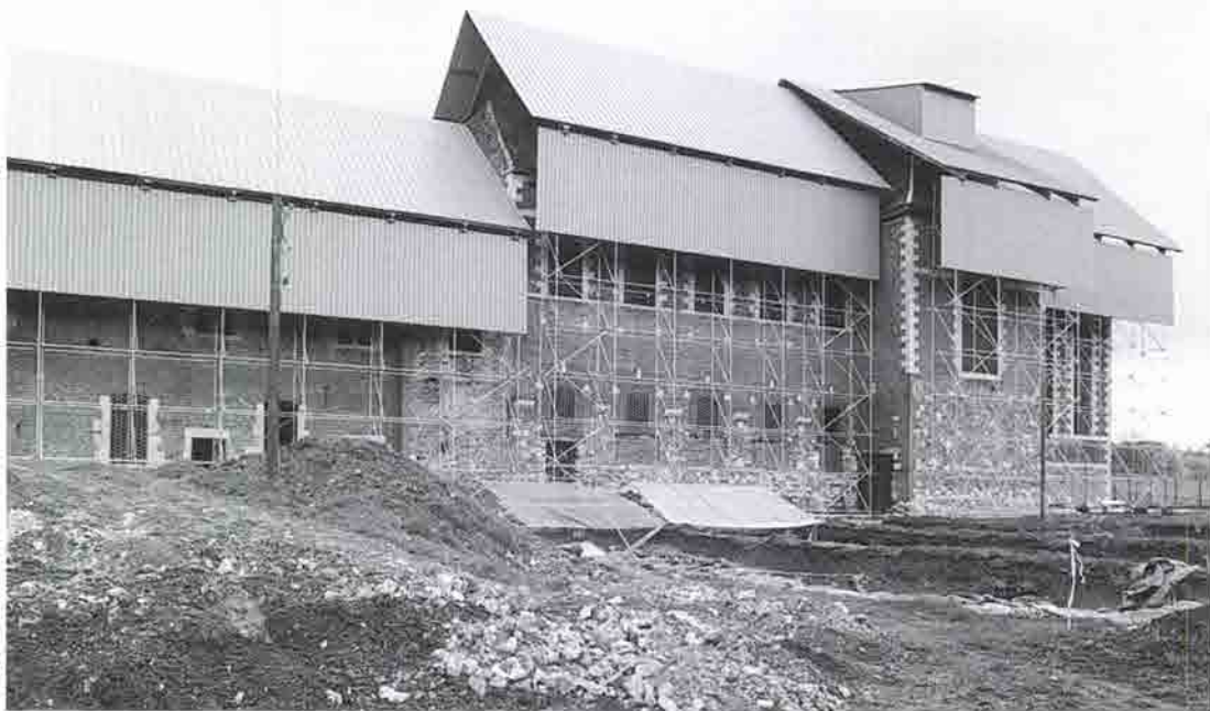
AMAY - Jehay, chantier de restauration de la Paix - Dieu. Cliché G. Focant, DPat, © MRW.
