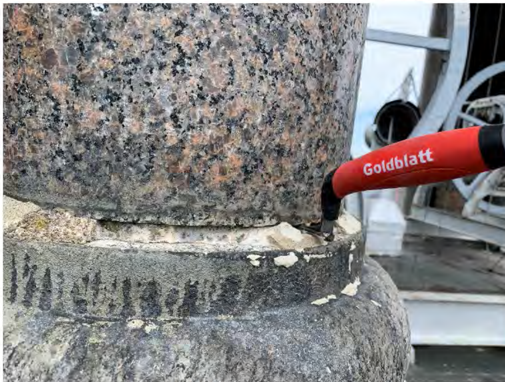
Photo 31 : Joint de maçonnerie endommagé
