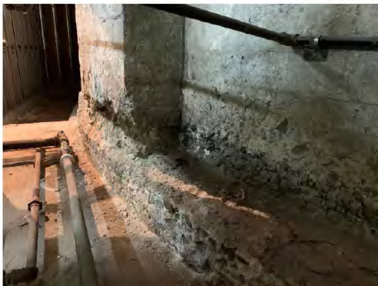
Photo 3 : Mauvaise qualité du béton autour d'une ancienne ouverture
