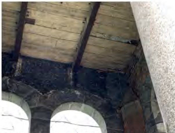
Photo 27 : Fissure au sommet du clocher est et bris des dalles de béton
