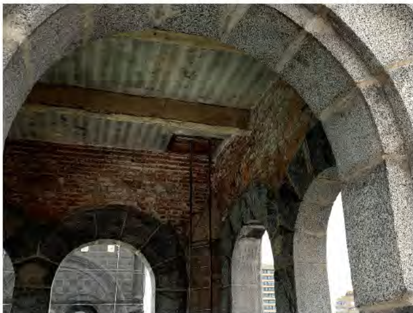
Photo 19 : Dégradation de la maçonnerie de briques
