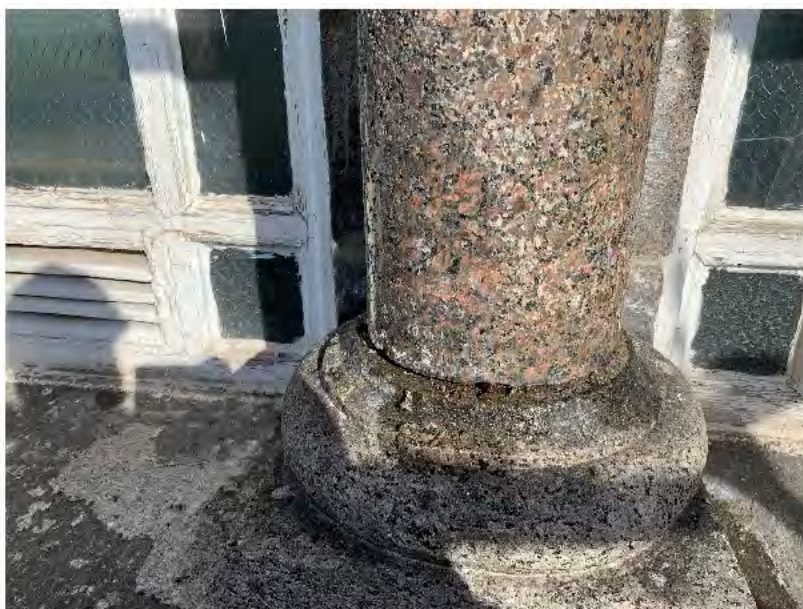
Photo 17 : Dégradation d'un joint à la base d'une colonne de granit
