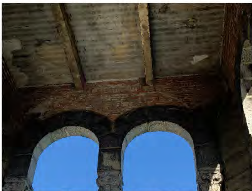
Photo 18 : Fissuration des arches
