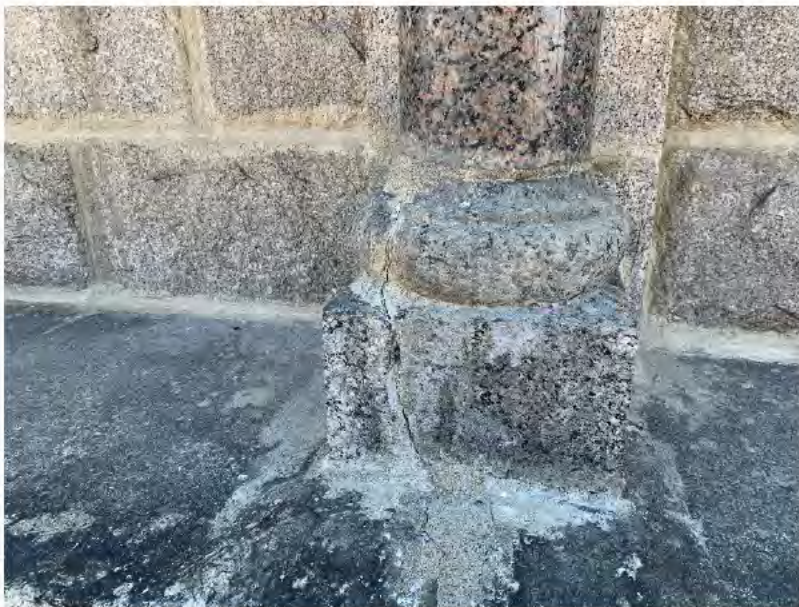
Photo 25 : Fissure sur une pierre d'assise d'une colonne de granit sur la face est
