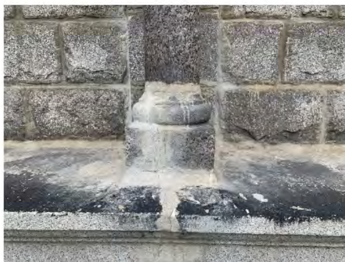
Photo 30 : Bris de la pierre d'assise d'une colonne de granit
