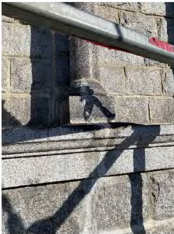
Photo 16 : Fissuration de la base d'une colonne et du parement
