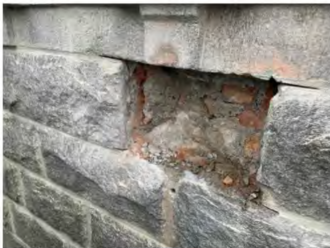
Photo 20 : Ouverture exploratoire dans le parement
