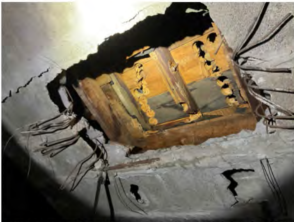
Photo 11 : Exemple de dalles évidées de béton préfabriqué sectionnées sans renfort
