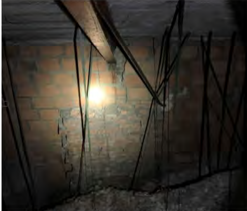
Photo 5 : Fissure observée dans le parement intérieur
