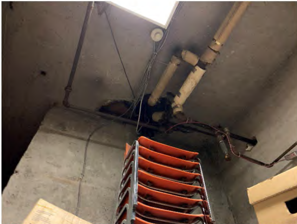
Photo 9 : Exemple de dalles évidées de béton préfabriqué sectionnées sans renfort
