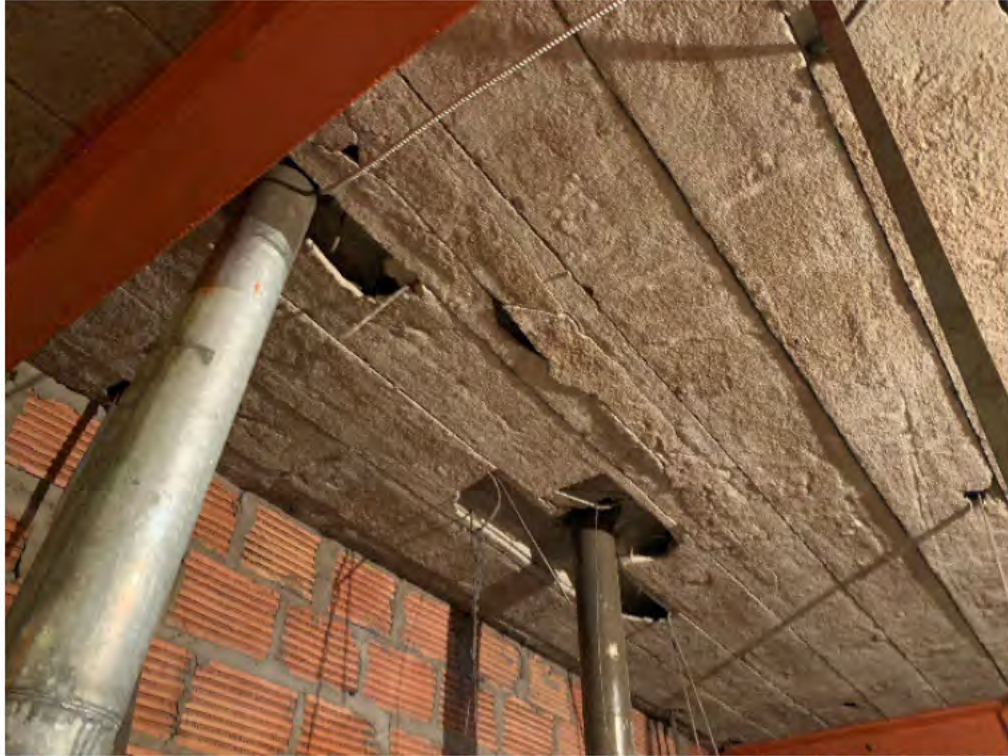
Photo 8 : Exemple de dalles évidées de béton préfabriqué sectionnées sans renfort
