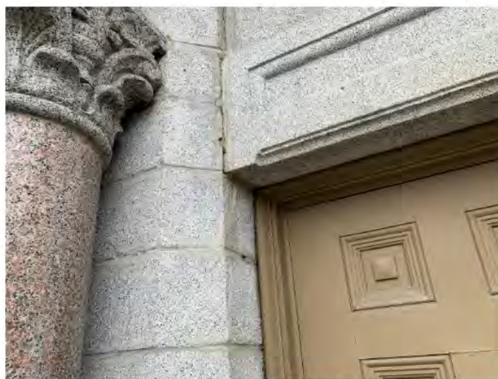
Photo 29 : Fissuration à l'appui du linteau
