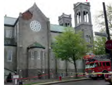
Écroulement d'une partie de la maçonnerie, 2017. Source : Radio-Canada.
