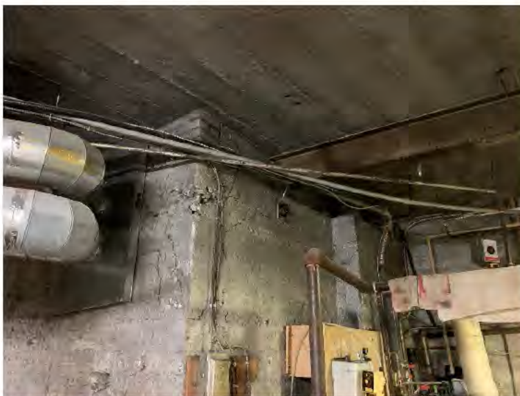
Photo 4 : Fissuration de la base en béton de la cheminée
