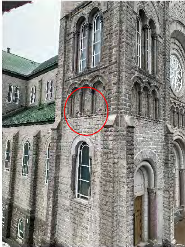
Photo 12 : Localisation du défaut
