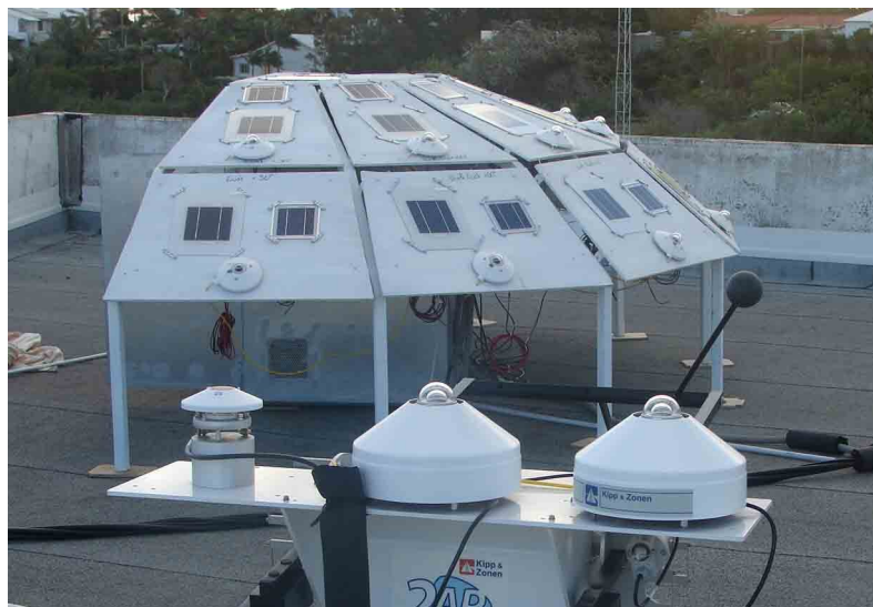
Figure 11 : Tracker solaire (premier plan) et structure semi-hémisphérique comportant 14 plans inclinés (second plan).
