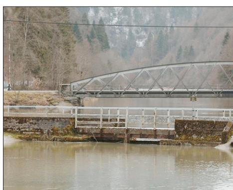
BIAUFOND Au fond, le pont franco-suisse à refaire. Mardi, commence la pose d'un ouvrage provisoire.
