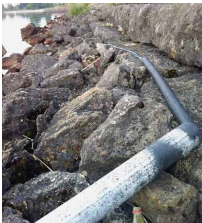
A la hauteur du qui Max-Petitpierre, soit en face d'un bâtiment de Viteos, câbles et gaines longent la rive. SP
