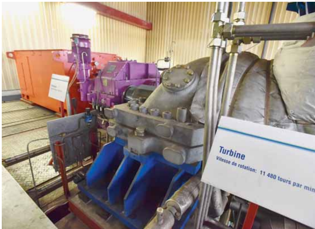
L'installation qui produit de l'électricité à partir des déchets incinérés par Vadec à La Chaux-de-Fonds.
