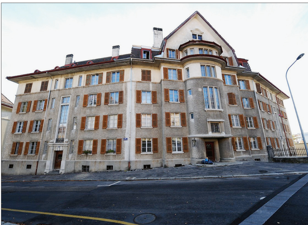
BÂTIMENTS COMMUNAUX Presque tout est à refaire dans l'immeuble Cernil-Antoine 27-29. Un crédit de pas loin de cinq millions de francs a été voté récemment au Conseil général. (CHRISTIAN GALLEY)
