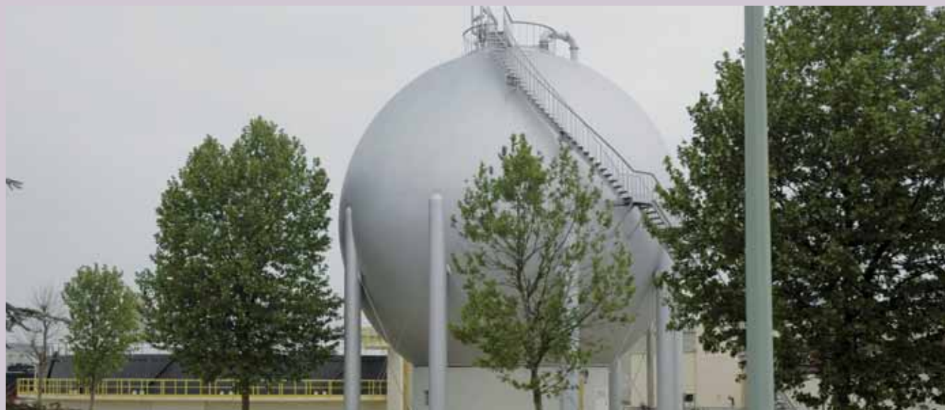
Installation de biogaz à l'usine Seine-aval.
