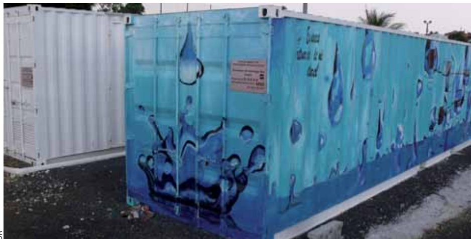
La station mobile des traitement des eaux usées, décorée par les enfants des écoles.
