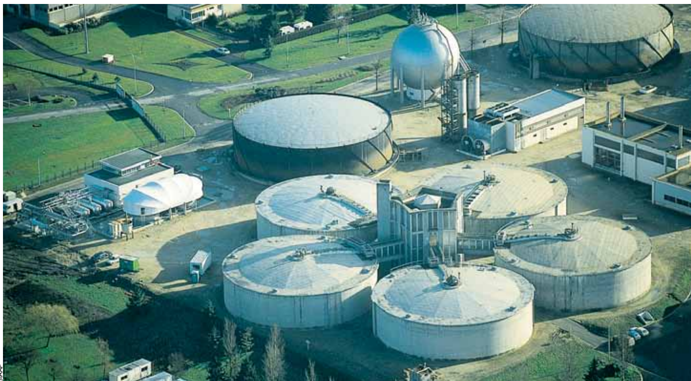
Les digesteurs à l'usine du Siaap de Marne-Aval.
