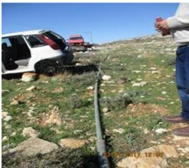
Beitunia, un réseau de distribution à même le sol et en mauvais état
