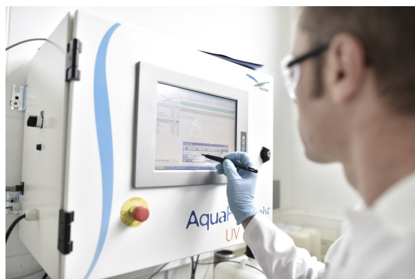
Usine de Mézières-sur-Couesnon Analyseur en ligne pour un suivi en continu de la qualité de l'eau © SAFEGE - Franck DUNOUAU
