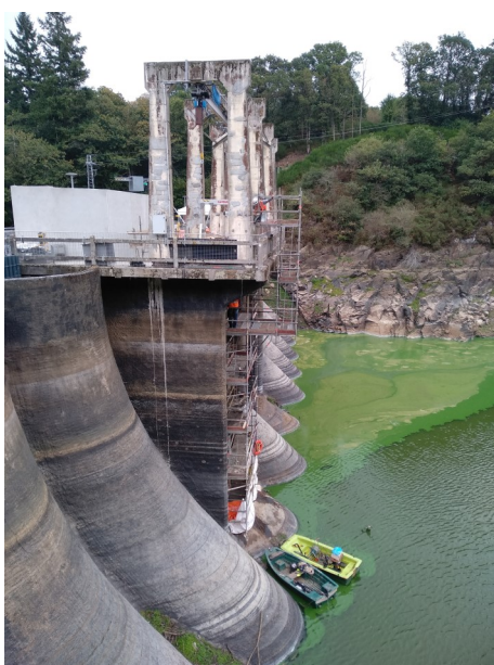
Barrage de Rophémel Poursuite des travaux en entrée des conduites forcées lors de l'abaissement artificiel pendant l'été 2018
