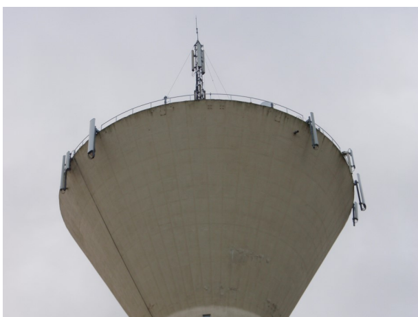
Antennes sur le dôme du réservoir de Thorigné-Fouillard
