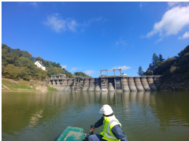
Déplacement sur la retenue de Rophémel pour réaliser l'inspection du parement amont 13 septembre 2018 © GEOS
