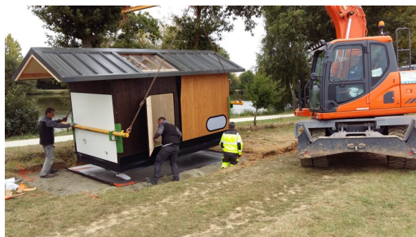
Installation de toilettes sèches financées par le fonds ECODO Étang de Blavon - Bédée Octobre 2018
