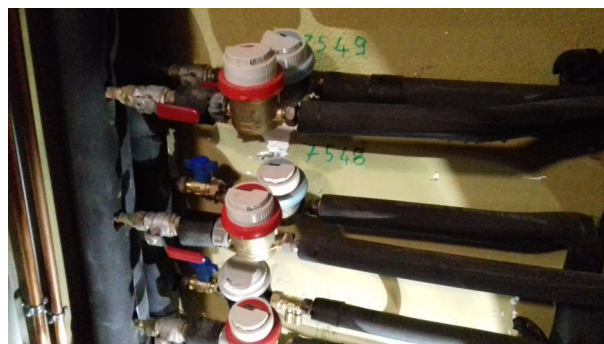
Individualisation des consommations d'eau froide dans un immeuble Rue de Dinan - Rennes
