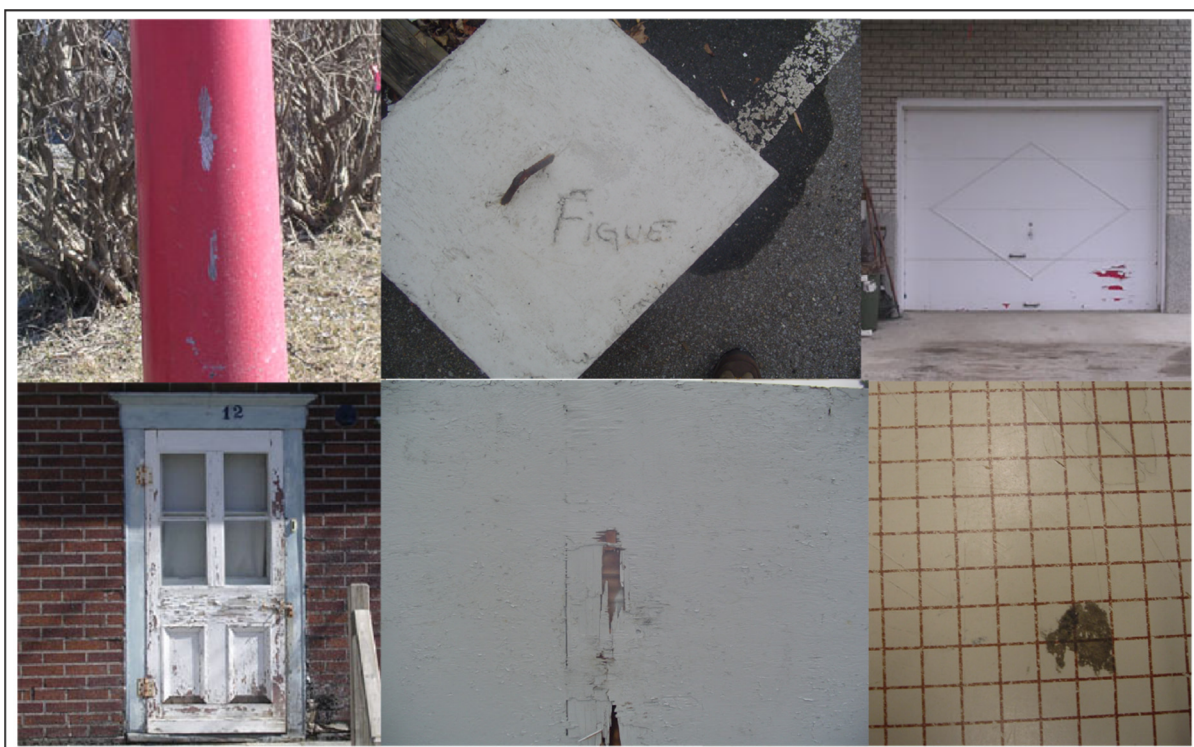
Figure 4 Exemples réels d'effets de détérioration.
