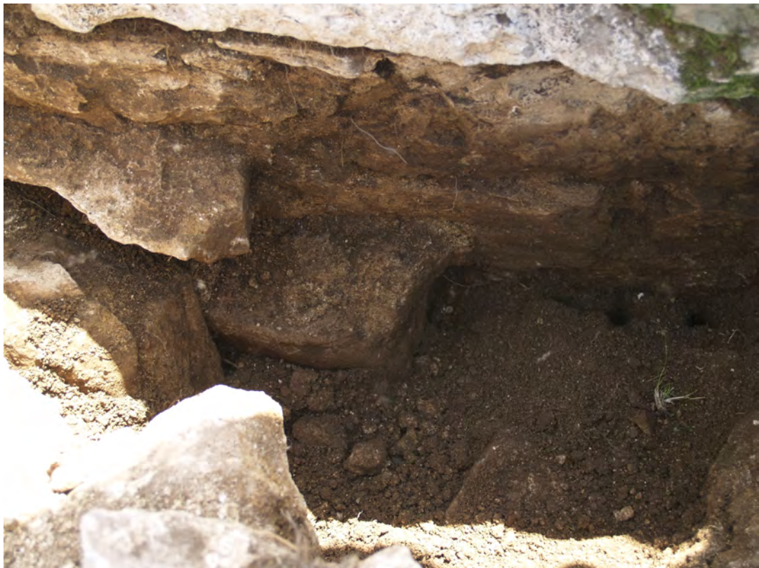
Photo 40 - N2 : probable arrachement (photo B. Duvivier).
