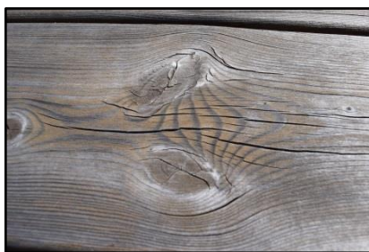
Fig. 1 : Exemple de dégradation par l'enseillement
