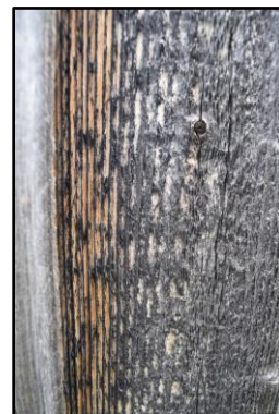
Fig. 2 : Exemple de dégradation par la pluie
