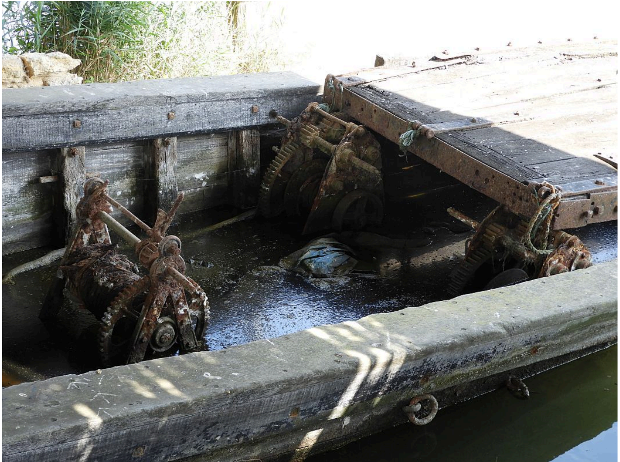
Treuils de manoeuvre des ailes.
