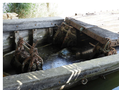
Treuils de manoeuvre des ailes. Phot. Yannis Suire IVR52_20188500422NUCA
