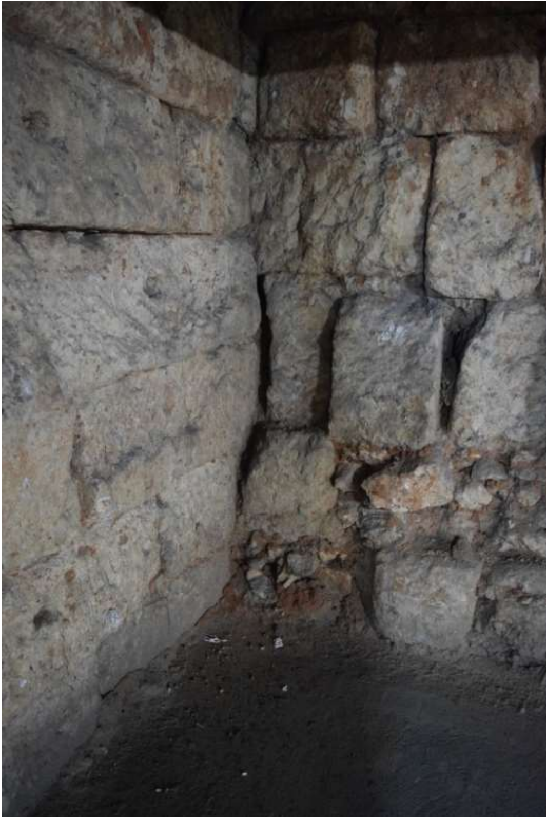
Fig.36e: Détail de l'union intramuros dans la partie inférieure de la trame avec la tour rectangulaire à talon
