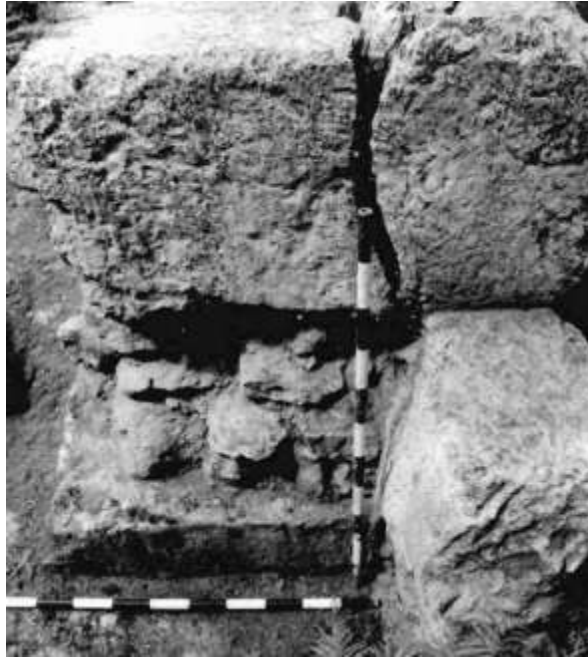
Fig.91b: Détail du remplissage interne de la muraille romaine, et détail d'une brèche dans le parement nord (Montejo, Garriguet, 1994: 275 lám 7)
