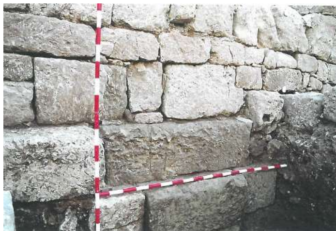
Sillares réutilisés (phase II) dans la courtine extérieur de la muraille avec une marque de taille
