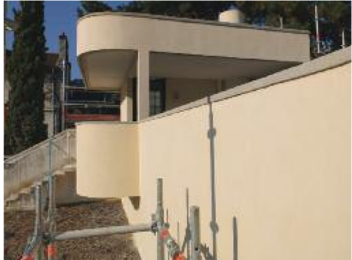
Photo de chantier des façades, restitution de l'enduit d'origine « ton pierre ». Ph. Bénédicte Gandini, octobre 2014.
