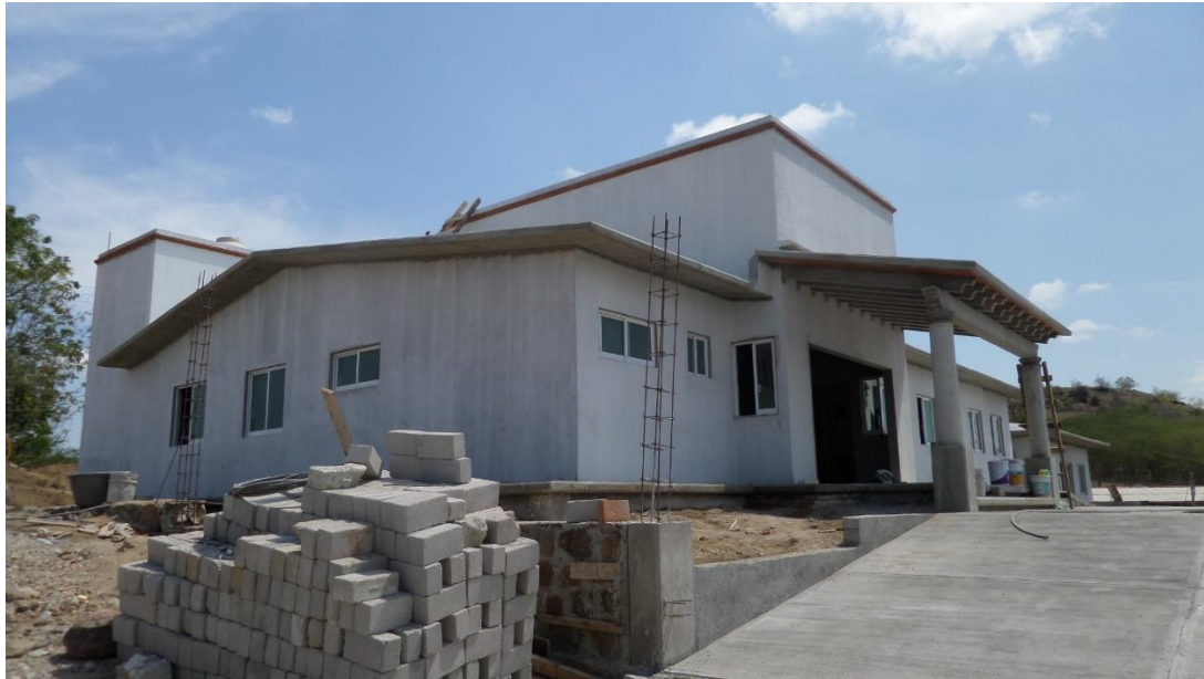
Figure 3. « Nouvelle » clinique de Lagunillas (construction interrompue)
