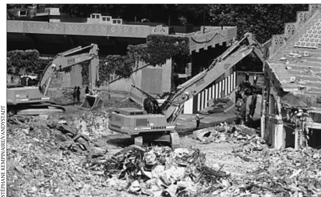
La rénovation du stade construit pour les Mousquetaires de la Coupe Davis dans les années 30.
