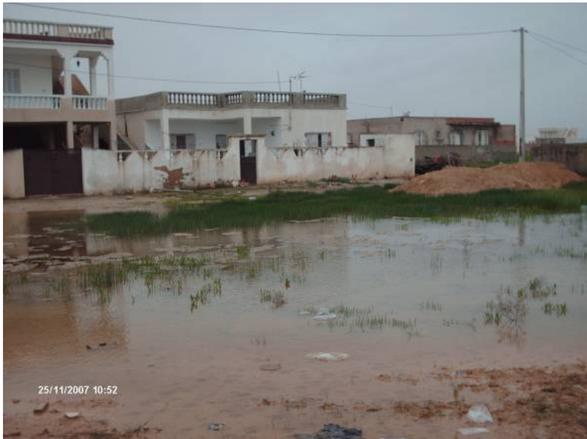
Photo n°11 : Plusieurs constructions à Raoued sont installées sur une nappe affleurante.
