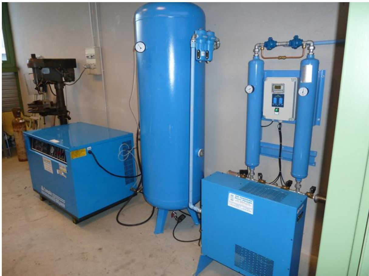
Figure V-30 : Compresseur d'air et son système de purification
