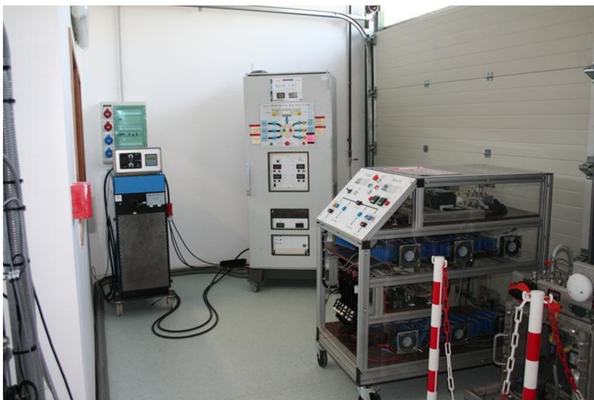
Figure V-32 : Espace « prototypes électriques »
