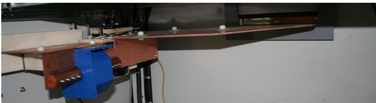
Figure V-10 : Bus barre du banc Forte Puissance « FP »
