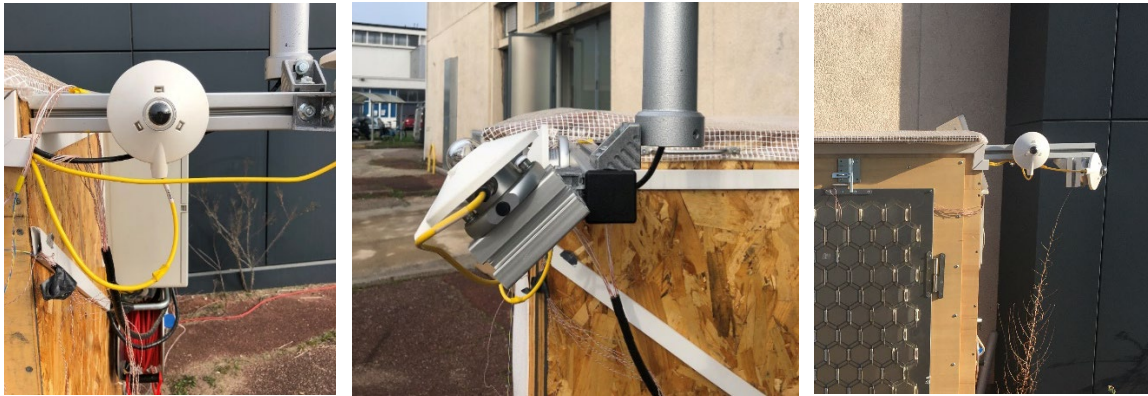
Figure 3.27 - Pyranomètre vertical et pyranomètre orientable installés sur la boîte test.
