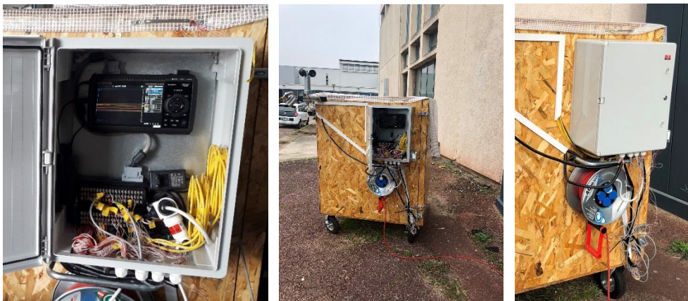
Figure 3.26 - Centrale d'acquisition et ses 40 voies dans le boîtier électrique et relié au câble d'alimentation fixé sur la boîte test.
