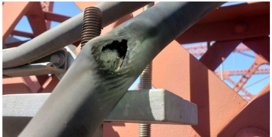
Câble d'alimentation électrique du tram à Portland (Oregon) endommagé par la chaleur.
