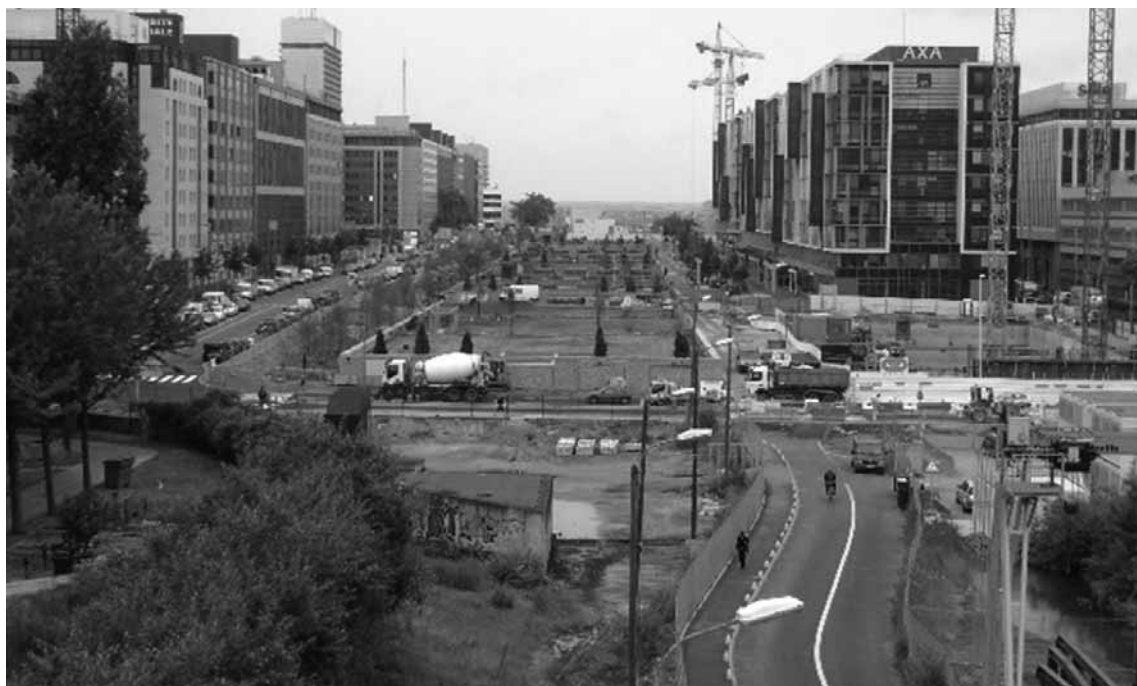
Vista dei cantieri in corso del progetto urbano Seine-Arche (Parigi-Nanterre, giugno 2009 - foto di N.T.)
