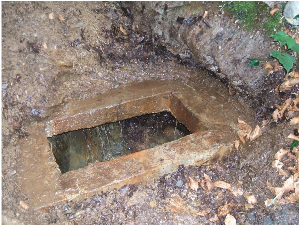
Illustration 12 : Cliché du captage de « Matech amont »
