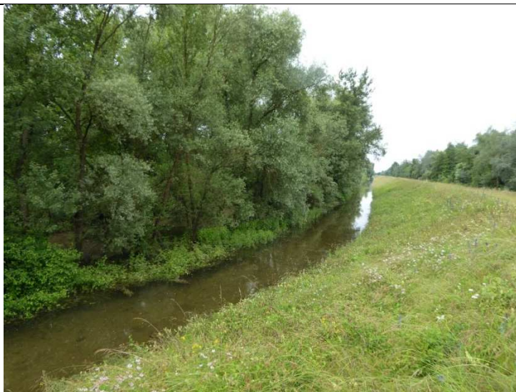
Photo 1 : Mise en charge du talus amont de la digue du contournement du port d'Offendorf au PK 412.429, le 21 juin 2016
