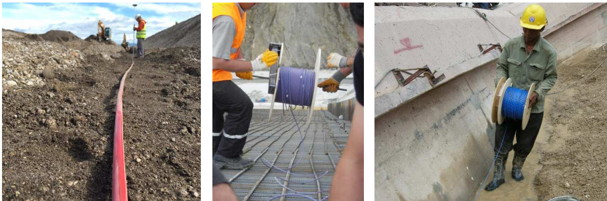
Figure 6 : Installation câble mesure de température, de gauche à droite : digue de la Save (Slovénie), barrage de Bagbasi (Turquie), barrage de Nam Ngum 2 (Laos)
