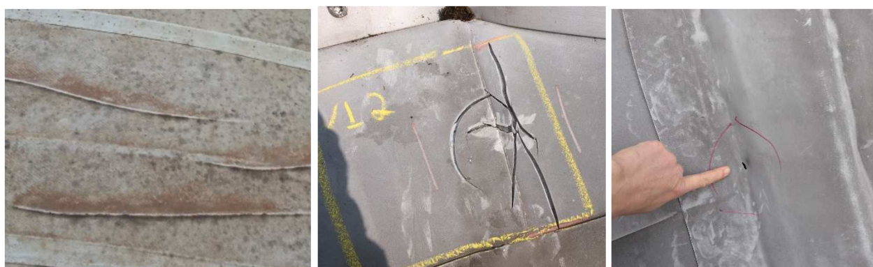
Figure 10 : Détail de plis de la membrane (Les Pradeaux, gauche), rupture fragile et déchirure contre les profilés à la naissance des voûtes de Butgenbach (centre et droite)
