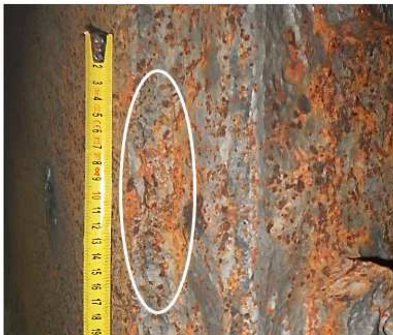
Figure 14 : Aperçu d'une soudure à l'état de surface trop irrégulier pour un contrôle ACFM.
