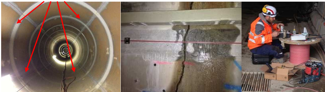
Figure 10 : Installation dans la conduite forcée (gauche) et tunnel d'accès (centre et droite)
