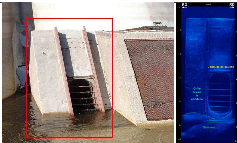
Prise de vidange Rive Droite - barrage des Pradeaux
