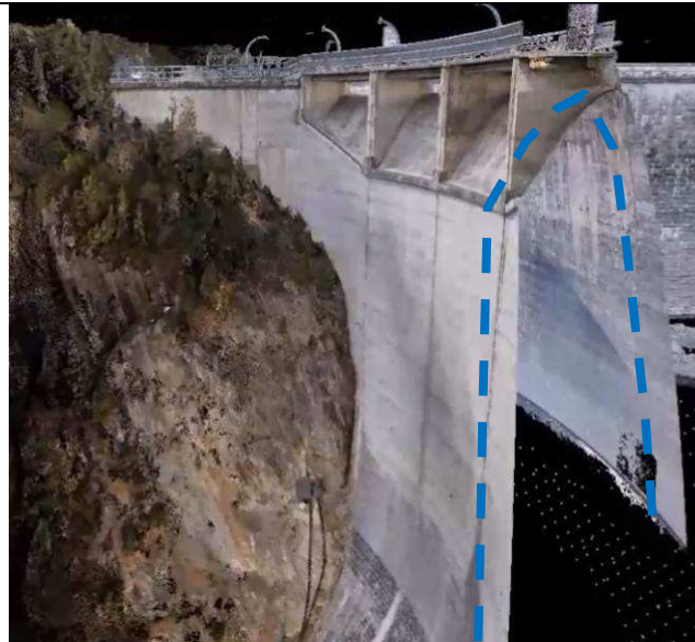
Figure 10 - Réalisation d'une vue écorchée (« coupe ») du barrage voûte rive gauche de Plan d'Aval à partir du modèle 3D, constitué d'un nuage de points texturé, bâti sur la base des relevés effectués par drone et laser
