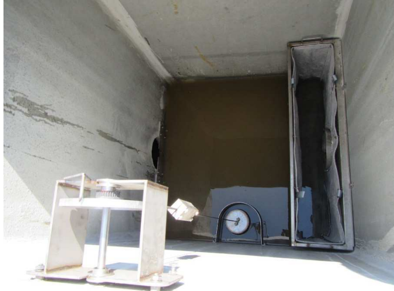
Figure 8 : regard équipé pour la mesure du transport solide et du débit
