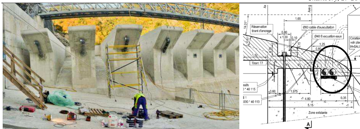
Figure 11 – a) Sortie des aérateurs du barrage de Malarce, b) Coupe sur les aérateurs et les têtes de tirants actifs
