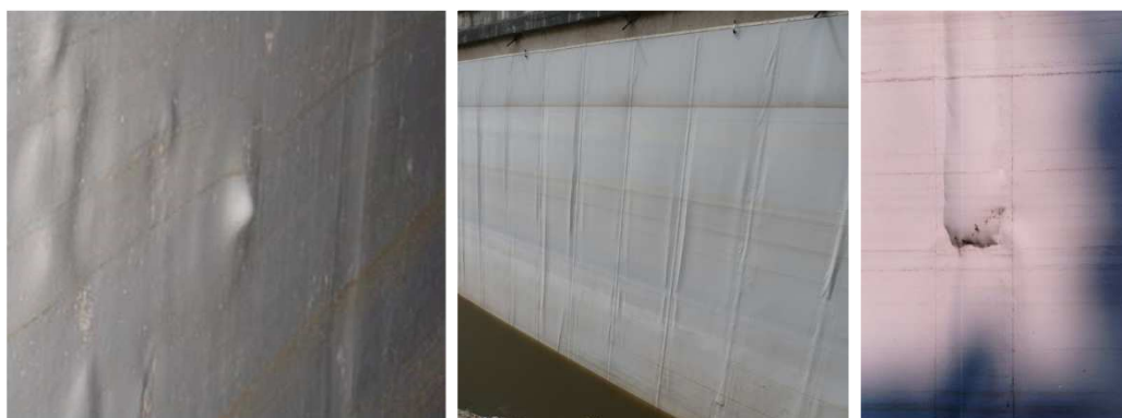
Figure 9 : Reliefs et déformations de la membrane de Chartrain (gauche), membrane de L'Echappe en 2015 (centre) et détail de la poche d'eau (droite)
