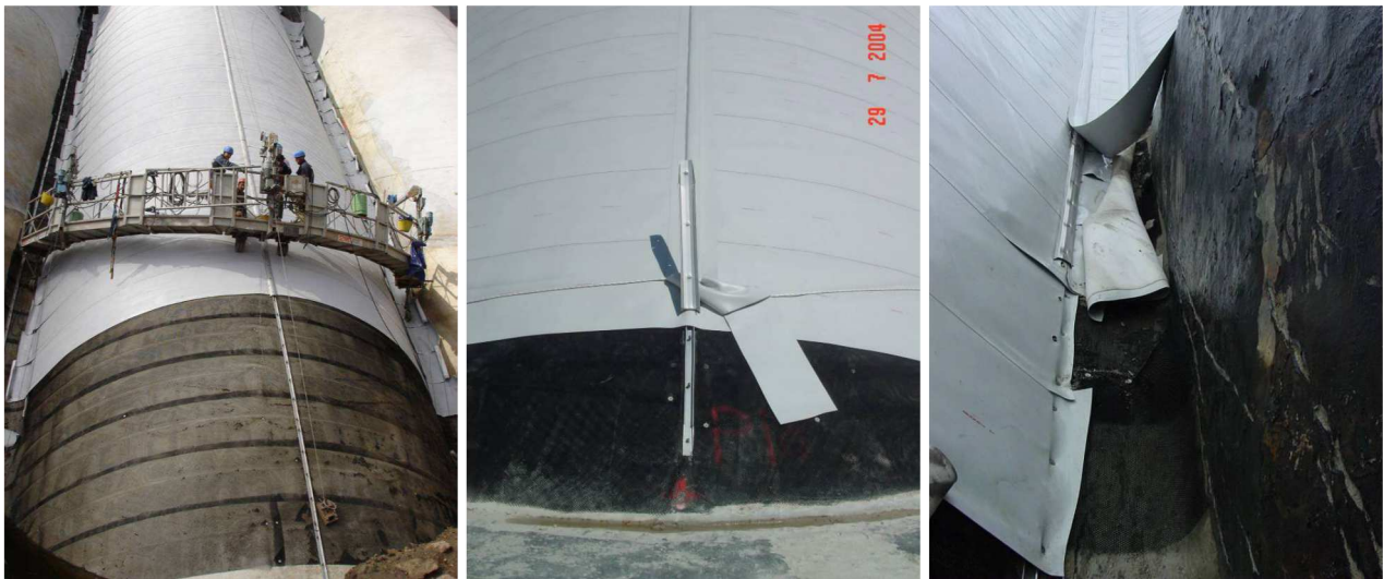
Figure 5 : Nacelle (Pradeaux, gauche), mise en place des lés des voûtes à Butgenbach (centre) et détail sur contrefort et bloc de vidange (droite)
