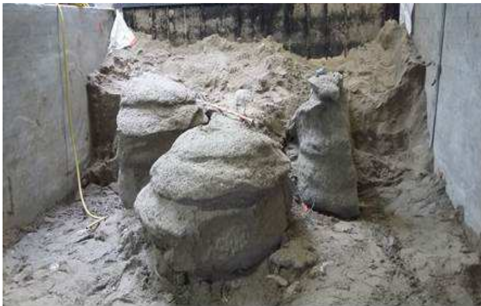
Figure 5 : Blocs calcifiés après excavation dans du sable 0/4 mm, au-dessus de la fondation graveleuse (essai B1).
