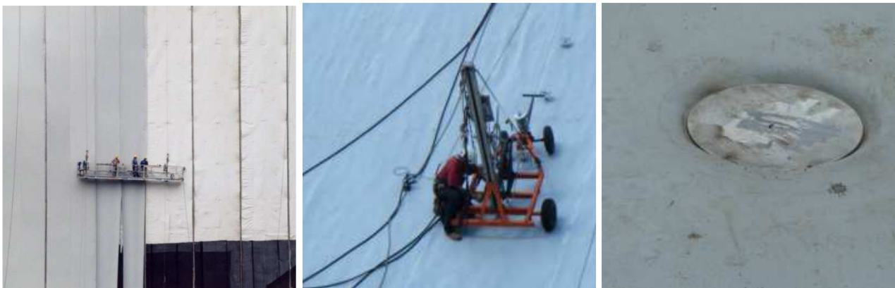
Figure 6 : Mise en place de la géomembrane (gris), du géotextile (blanc) et de la géogrille (noir) sur parement maçonné (gauche), ligne de fixations ponctuelles (centre) et détail d'une tête d'ancrage avant recouvrement par une rondelle de géomembrane (droite) à Vaité 2.
