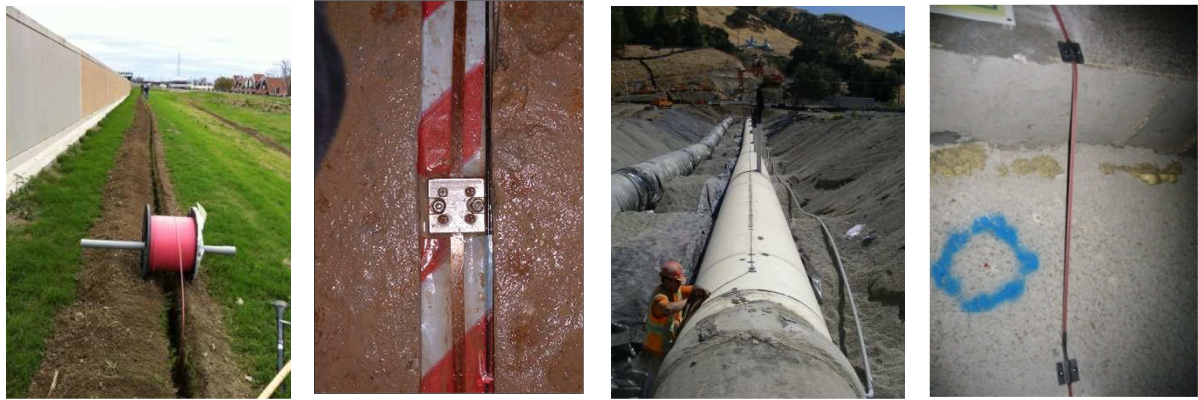
Figure 5 : Installation câble de mesure de déformation, de gauche à droite: digue projet iLevee à La Nouvelle-Orléans (USA) - câble enterré -, galerie du barrage Plavinu Hes (Lettonie) - rainurage sur béton - , conduite d'eau d'Alameda, Californie ( USA) - collage en continu -, Tunnel Hospitalet ,Barcelone (Espagne) - fixation périodique -
