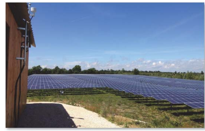
Parc Solaire avec Trackers – 5.7 MWc Bessens (82) Foncier Privé → Développement, Financement, Construction et Exploitation → Ancienne carrière d'argile
