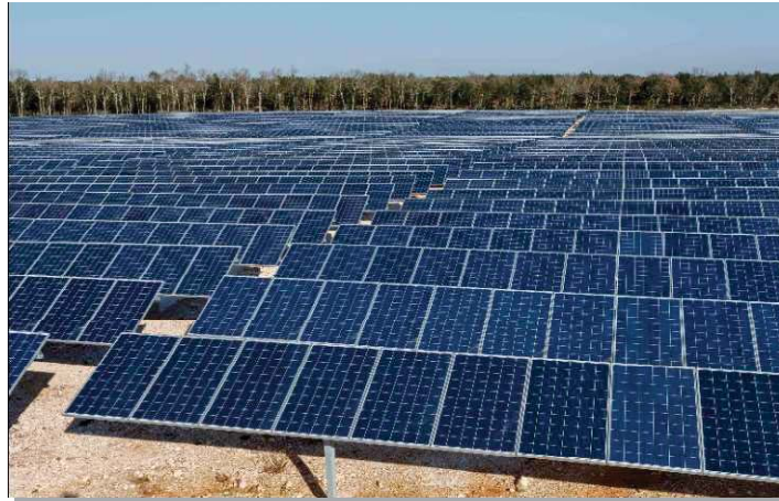
Parc Solaire avec Trackers – 4.7 MWc Vallérargues (30) Foncier Communal → Développement, Financement, Construction et Exploitation
