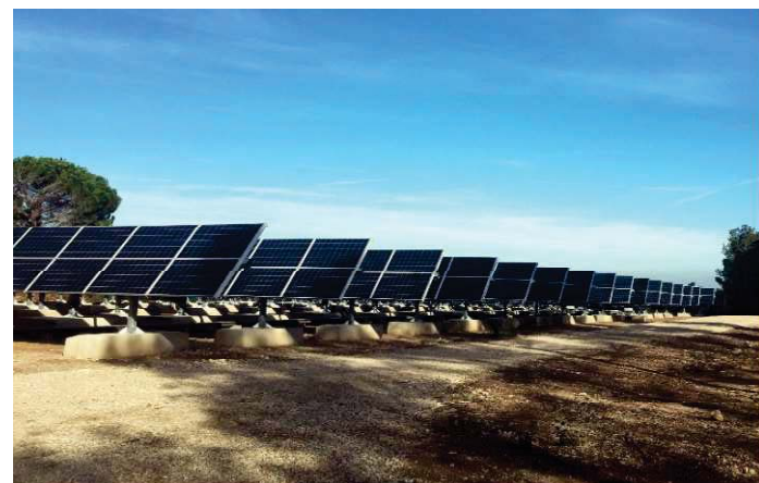
Parc Solaire avec Trackers – 1.3 MWc Fuveau (13) Foncier Communal → Développement, Financement, Construction et Exploitation → Ancien terril de mine / Site BASIAS
