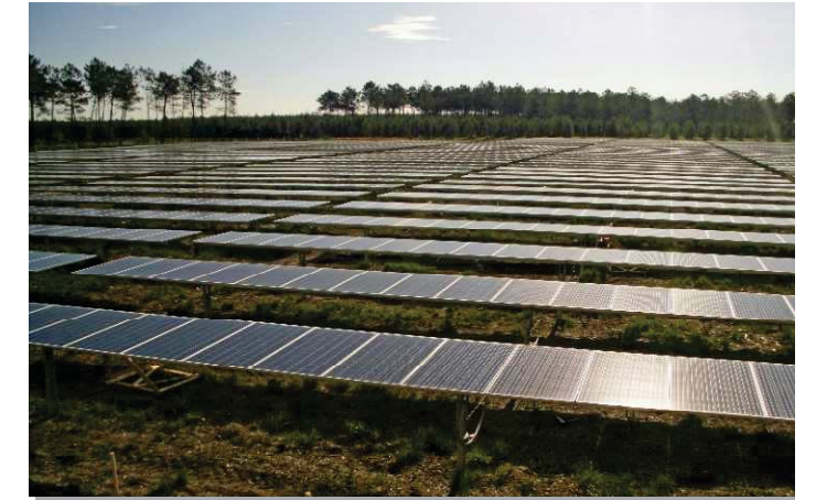
Parc Solaire avec Trackers – 12.0 MWc Sainte Hélène (33) Foncier Communal → Développement, Financement, Construction et Exploitation
