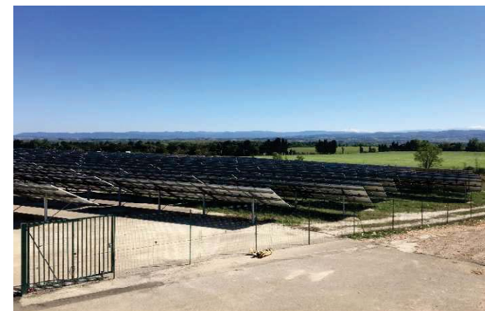
Parc Solaire – 7.4 MWc Moussoulens (11) Foncier Communal → Développement, Financement, Construction et Exploitation → Ancien aérodrome
