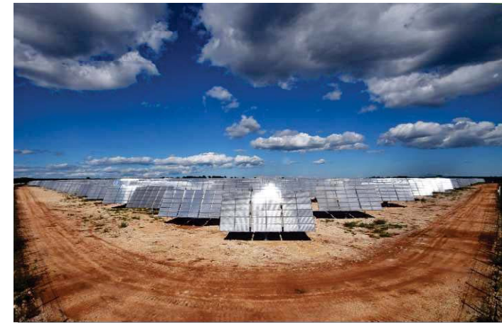
Parc Solaire à Concentration et Trackers – 10.7 MWc Aigaliers (30) Foncier Communal → Développement, Financement, Construction et Exploitation → Plus grande centrale à concentration de France
