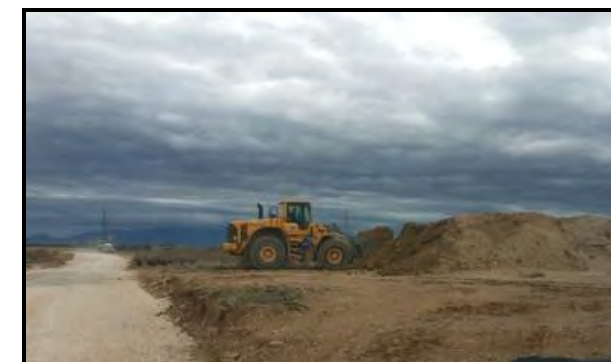
Figure 113 : Reprise de la terre stockée pour le remblayage des fondations (source : Abies, suivi de chantier éolien)
