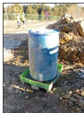
Figure 109 : Stockage d'hydrocarbures dans un bidon étanche sur un bac de rétention (source : Abies, suivi de chantier de centrale photovoltaïque)
