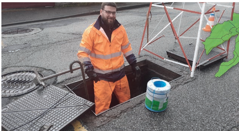
Les opérations de fibrage privilégient l'utilisation de réseaux déjà existants.
