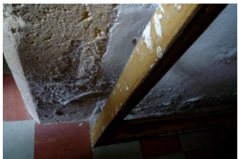
• Anti-chambre SO : Présence de salpêtre
