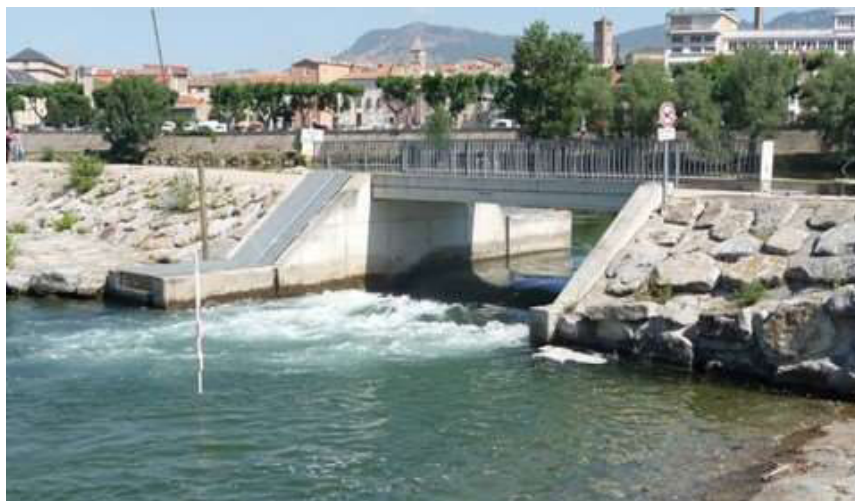
Figure 30 : Vanne-toit du parcours d'eau vive de Millau
