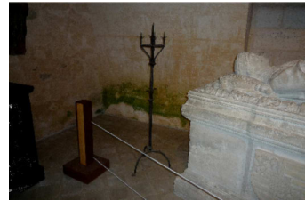
•LA CHAPELLE Remontée d'humidité sur une maçonnerie intérieure
