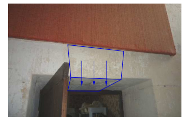
Le claveau central se désolidarise et commence à glisser (RdC)
