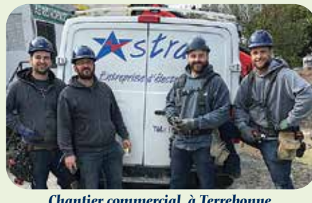
Chantier commercial, à Terrebonne. Travailleurs pour la compagnie Astral entreprise d'électricité. Félicitations aux confrères Julien Campeau, Dominic Jean-Higgins et Derick Dallaire pour leur changement de période d'apprentissage!
