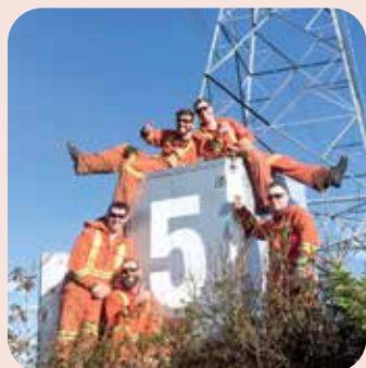
Travailleurs de lignes sur le changement d'isolateurs, 735 kV à Montagnais, Jeannot Bélanger, délégué.
