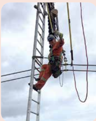
Jean-Eudes Lavoie, sur le changement d'isolateurs, ligne à 315 kV.
