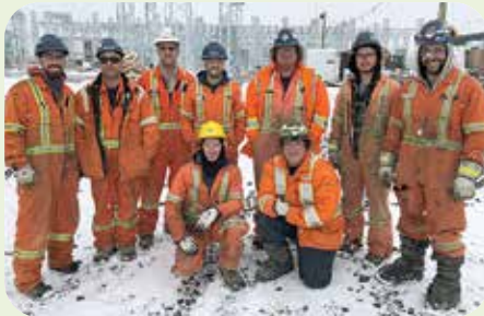
Chantier : nouveau poste des Patriotes à Saint-Eustache. Entrepreneur : Arno électrique. Contremaître : Jean-François Baribeau et André Bates. Représentant : Éric Fabre.
