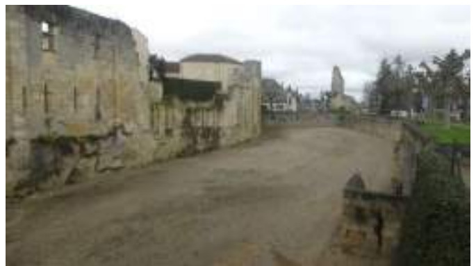
Fossés nord ouest, état des douves, interrogation sur leur niveau.
