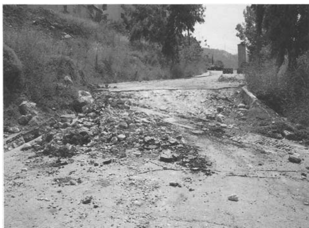
Figure 3. Route Faouar Antélias-Raboueh coupée par le glissement.
