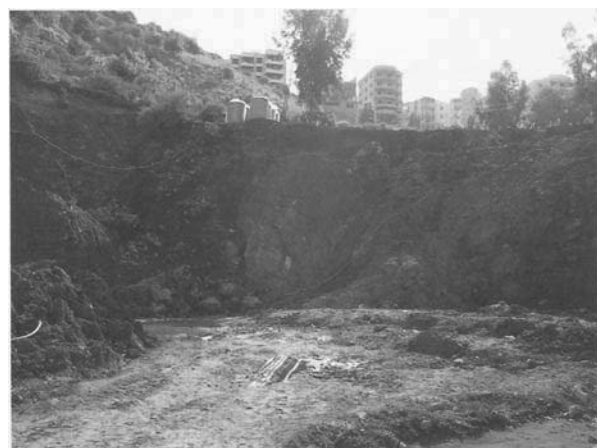
Figure 4. Le glissement de Antélias vers la fouille Mission la Vie. L'ouverture de la fouille serait un facteur déclenchant
