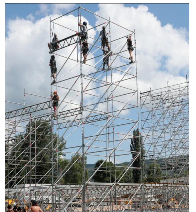
L'installation des deux grandes scènes du festival Musilac a commencé sur l'esplanade du lac d'Aix-les-Bains. Photo Le DL/Sylvain MUSCIO
