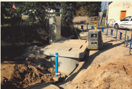
Poste de refoulement de Kernantec
