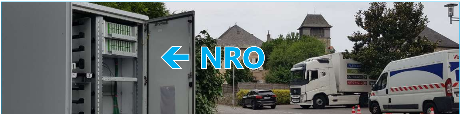
NOEUD DE RACCORDEMENT OPTIQUE (NRO)
