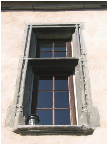
Fenêtre à traverse à baguettes toriques à base prismatique – Rue des Pallaches
