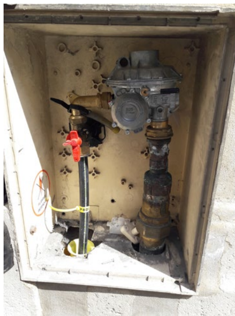
Détendeur de gaz pour immeuble © Pierre Bastard, 2019.
