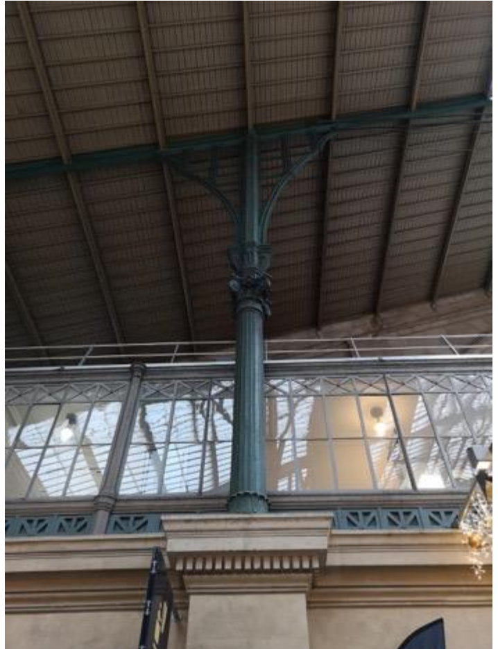
Figure 11 : Colonne à l'intérieur de la gare Source : Photo de Pablo Alonso González 2019.
