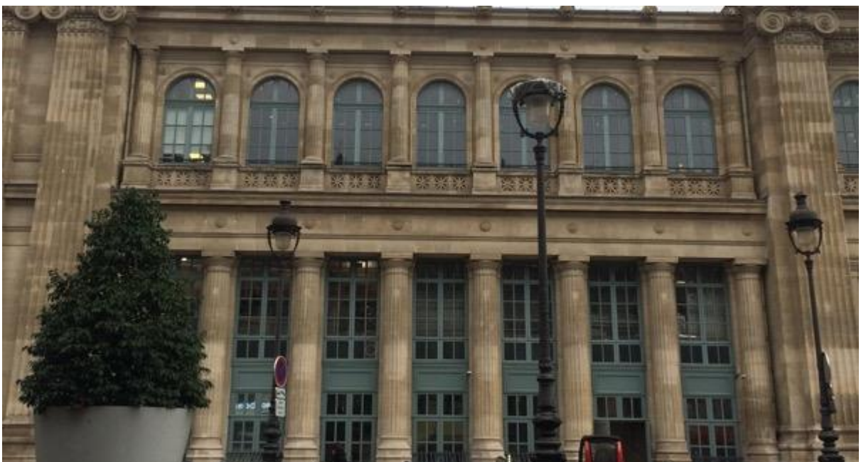
Figure 9: Photographie de la façade ou on voit la différence entre le premier et le deuxième étage de la gare. Source : Photo de Emmanuel Brito 2019.
