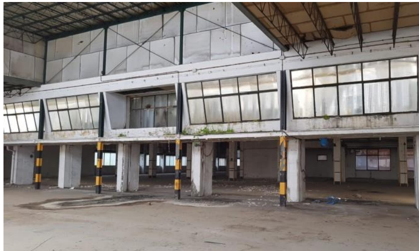
Figure 22 : Vue de l'état actuel des ateliers. Source : El Correo Web (Andalucía 07-06-2018) . L'état de la structure, comme on peut le constater, est en bon état, à peine affecté par l'usure typique de près de 15 ans d'abandon
