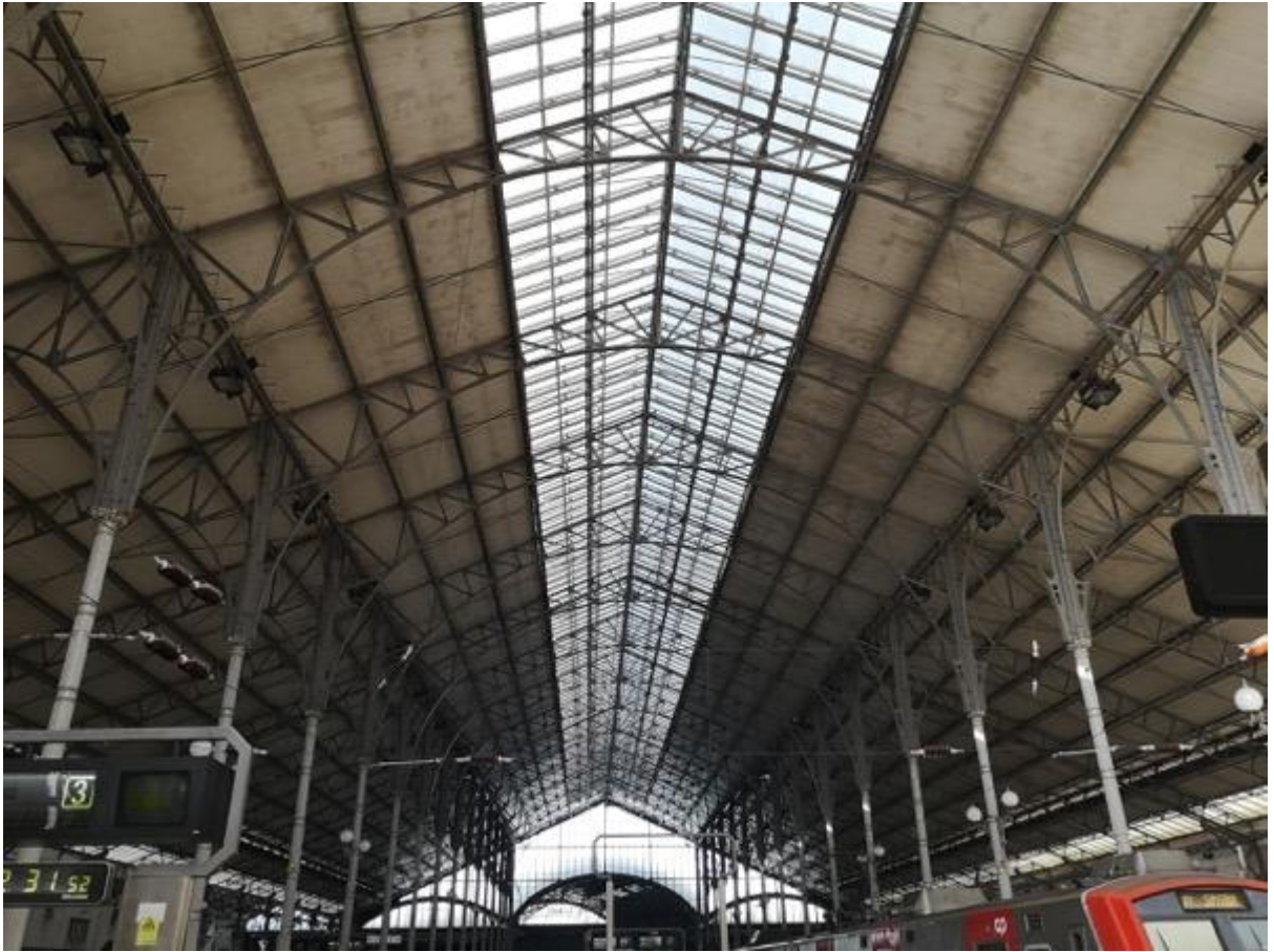
Figure 29 : Couverture des voies ferrées de la Gare du Rossio. Source: Photo de Pablo Alonso González 2019.
