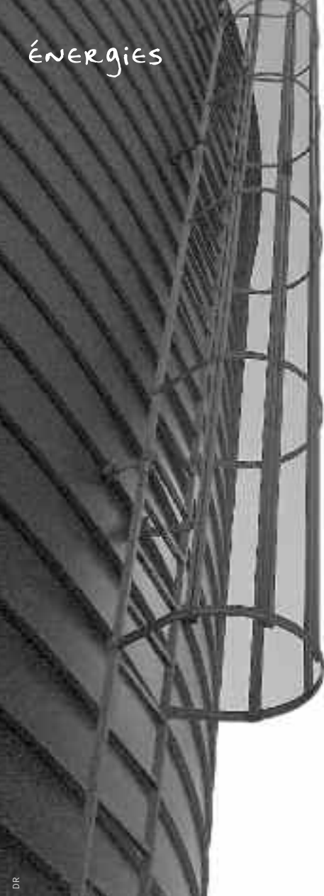
Digesteur de biométhane.
