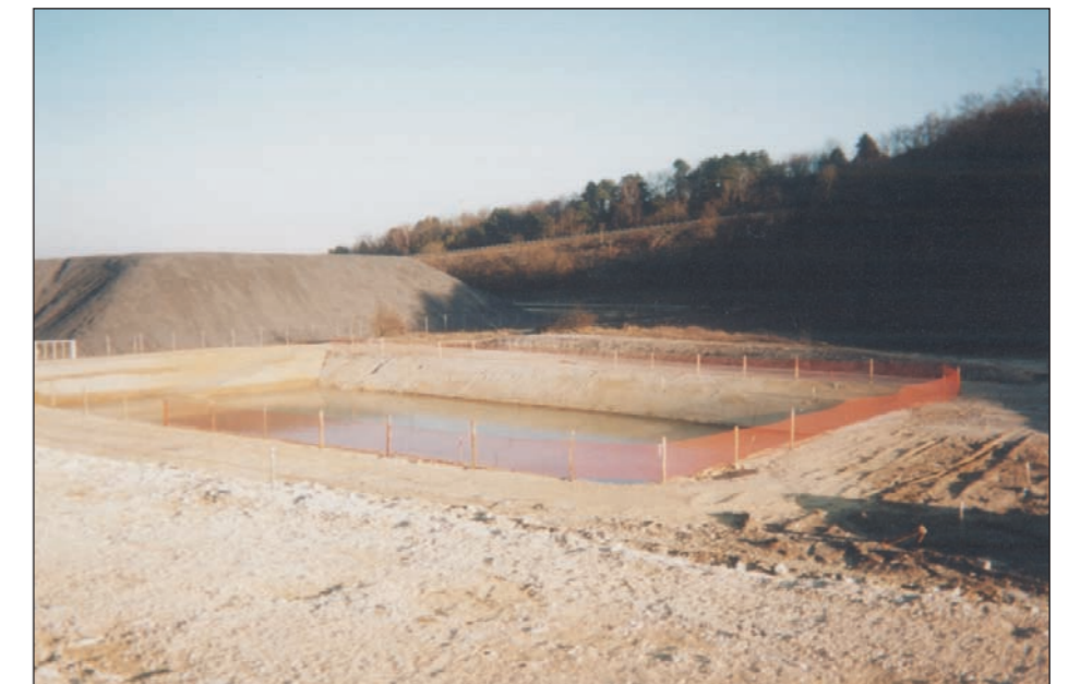
Bassins de rétention des eaux pluviales sur la LGV Est Européenne Source : G.E.E.A., 2003.
