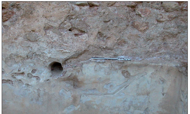
Figure B.108. Dépôt de travertins sur les dalles murales cassées de la salle T15 des thermes de Jebel Oust.
