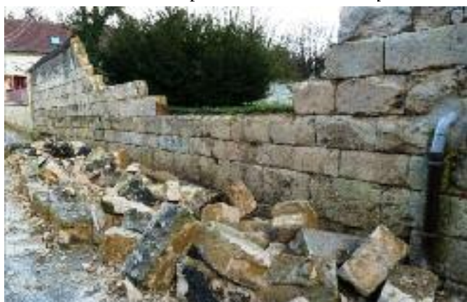
CHUTE DU MUR DE LA MAIRIE...
