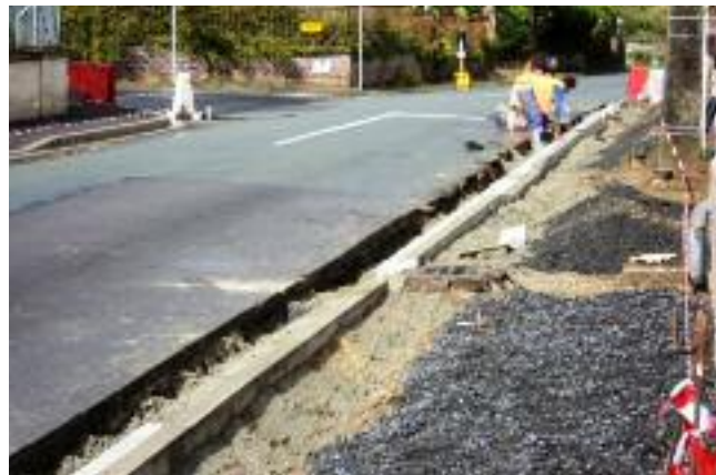
CRÉATION DE TROTTOIRS, RUE DE BAILLY
